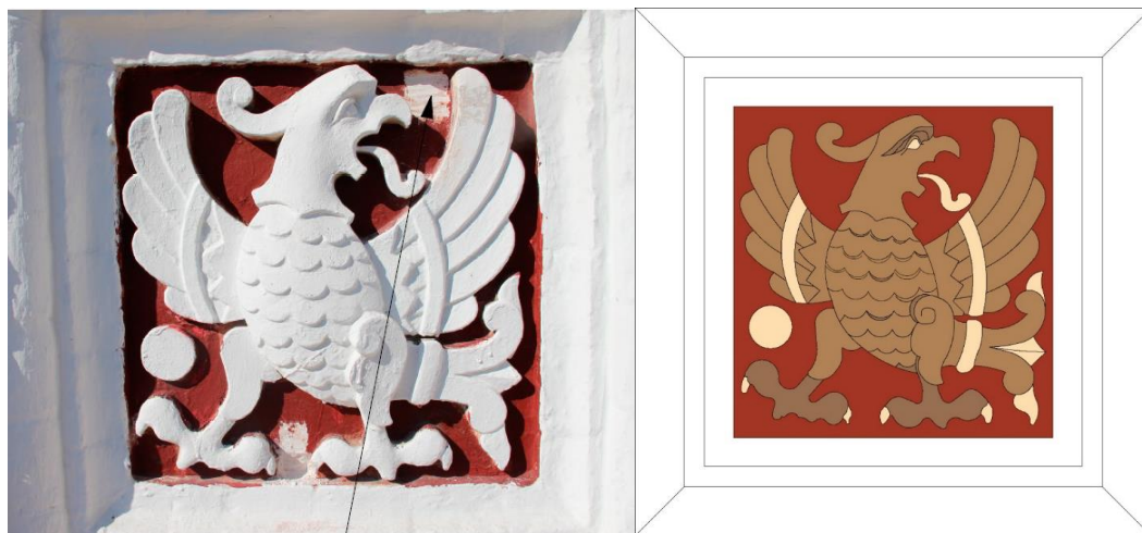
Рис. 2 (а, б) – а) Изразец «Василиск» главного фасада. Современное состояние. б) Схема первоначального цветового решения изразца «Василиск» второго этажа с первоначальным красным фоном и цветом слоновой кости в самом рисунке
