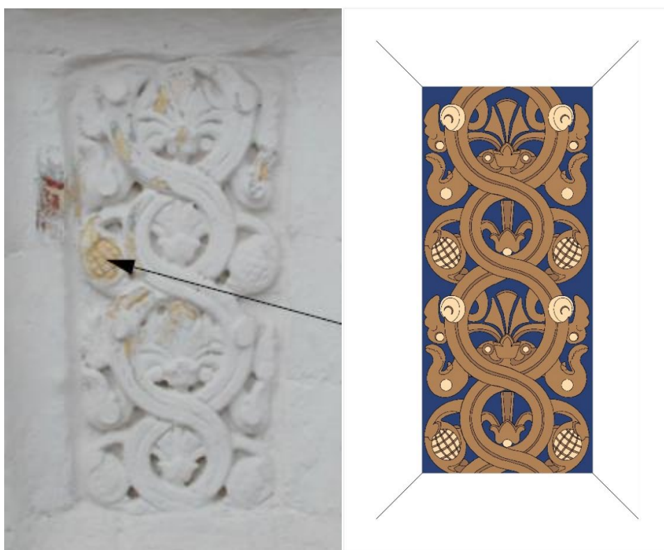
Рис. 7 (а,б) – а) Декоративная лента растительного орнамента. Существующее состояние. б) Схема первоначального цветового решения декоративной ленты второго этажа драматического театра по результатам проведенных исследований
